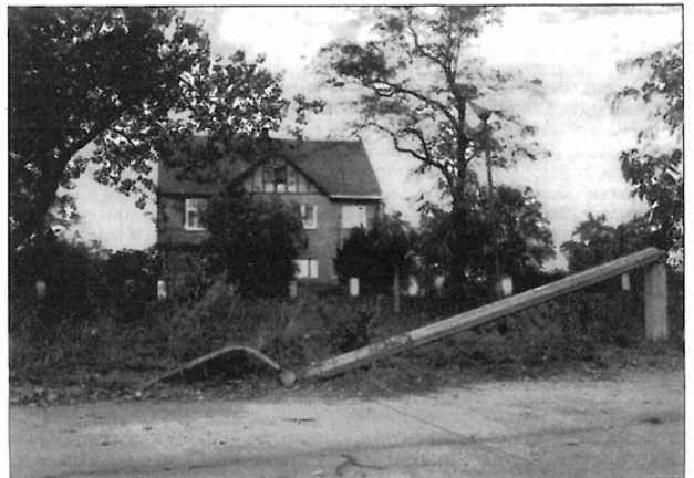
Złamany słup oświetleniowy przy Hortexie ( ul. Sportowa).
